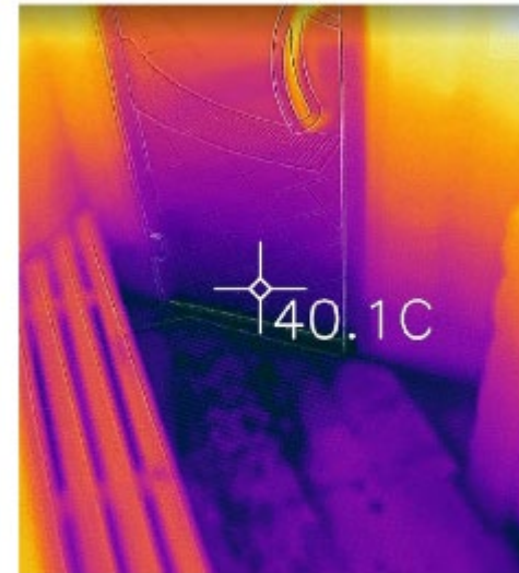
Bilde 16 termisk bilde av glassdøren til Finsk sauna, tatt fra innsiden
