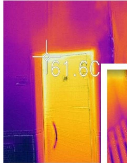
Bilde 15 termisk bilde av glassdørn sauna, tatt fra utsiden
